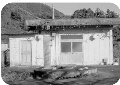
老朽化が進む水源地
