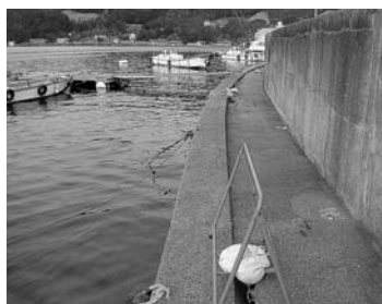
補修が急がれる迫間浦漁港県単改良事業箇所
